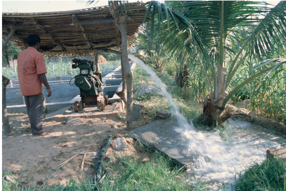
Pilotanlage bei Madras: Das Abwasser eines Internats wird nach Reinigung in einer ÖKOTEC-Anlage zur Bewässerung von Reisfeldern eingesetzt.
